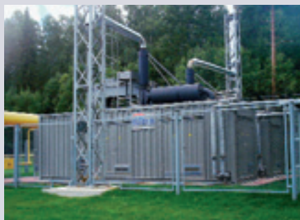
Двухагрегатная станция обеспечивает санаторий «Решма» (Ивановская обл.) электроэнергией и горячей водой
