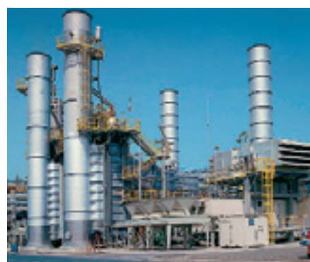
Фото 6. Газотурбинные установки SGT-500 с котлами-утилизаторами
