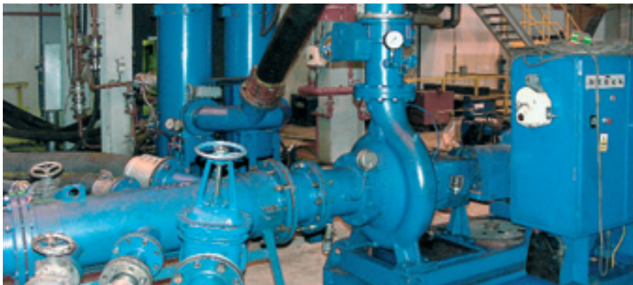
Фото 3. Насосная установка высокого давления установлена в цехе
