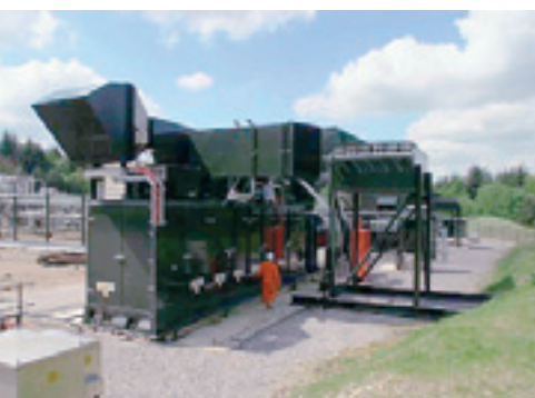
Фото 2. Блочная электростанция на базе SGT-100
