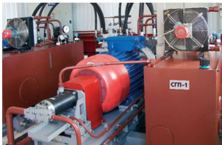
Фото 3. Станция гидрозапуска ГТУ
