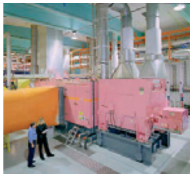
Фото 3. Электростанция цехового исполнения на базе SGT-200
