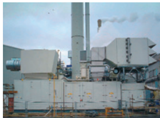
Фото 5. Газотурбинная электростанция простого цикла на базе SGT-400
