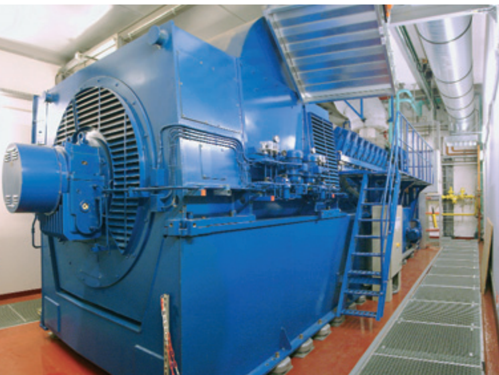
Фото 2. Газопоршневой агрегат TCG2032V16
