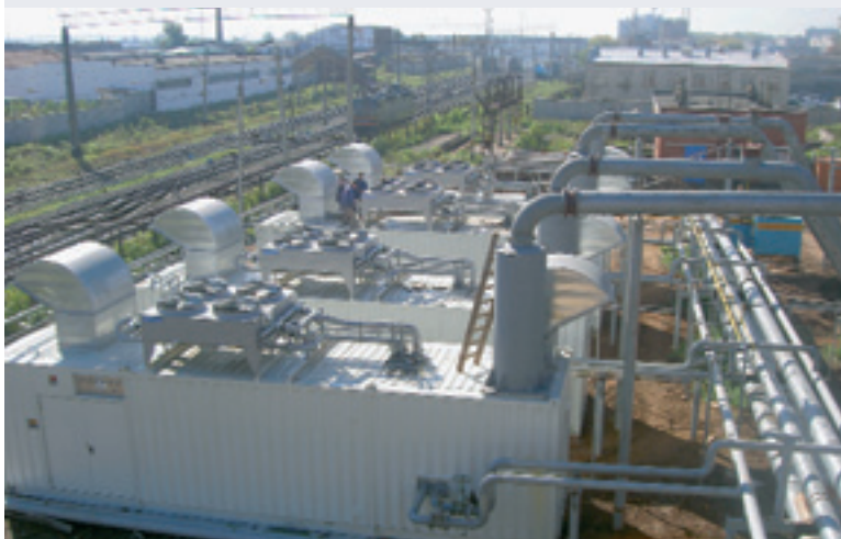
Блочная муниципальная электростанция с двигателями Caterpillar в г. Ижевске.
