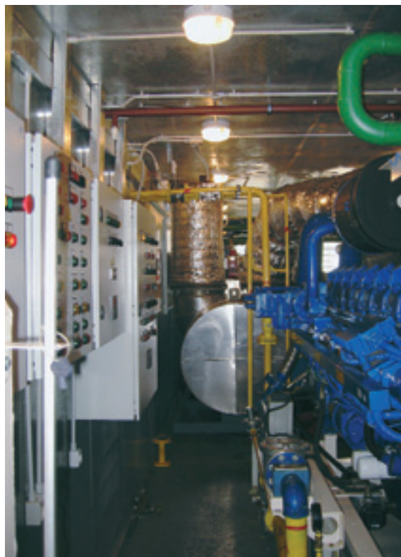
Фото 4. Газопоршневая установка PG1250B с системой утилизации тепла размещена в контейнере
