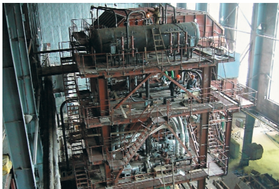
➔ Фото 2. Дожимной компрессор топливного газа
