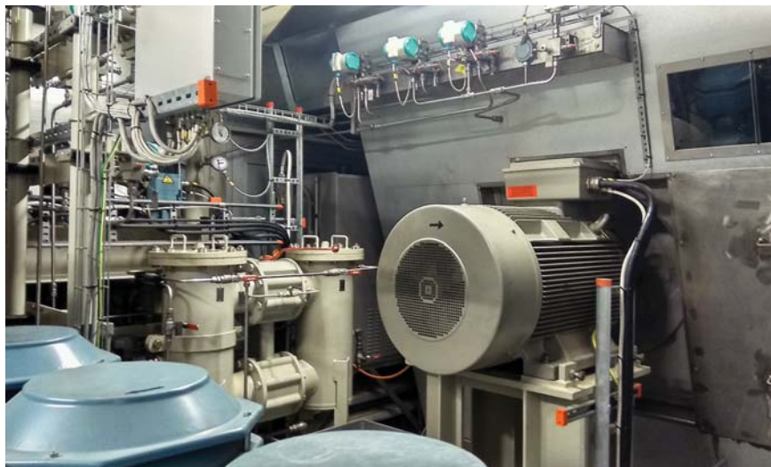
Системы газотурбинного энергоблока SGT-700
