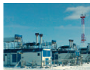
Фото на обложке. ГТЭС простого цикла мощностью 254 МВт, г. Туркменбаши
