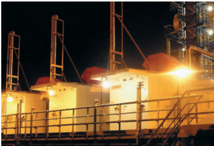
Табл. 2. Дожимные компрессорные установки Enerproject на КС для транспортировки ПНГ
