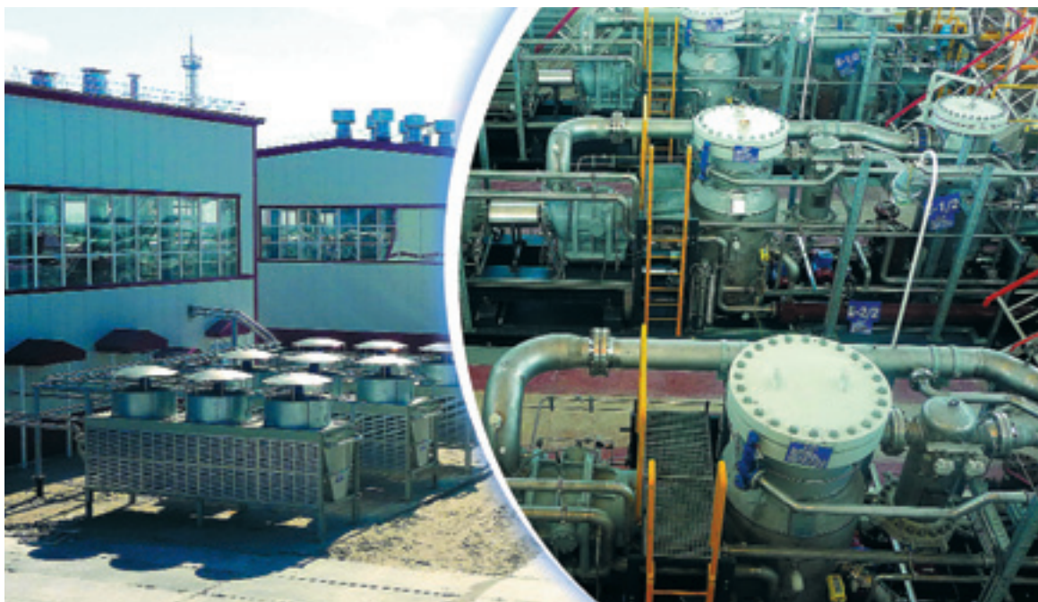
С Компрессорная станция на ДНС-3 Северо-Лабатьюганского месторождения
