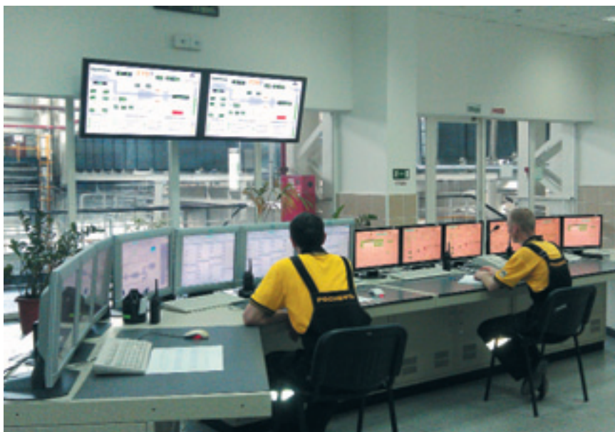
➤ Главный щит управления станции
