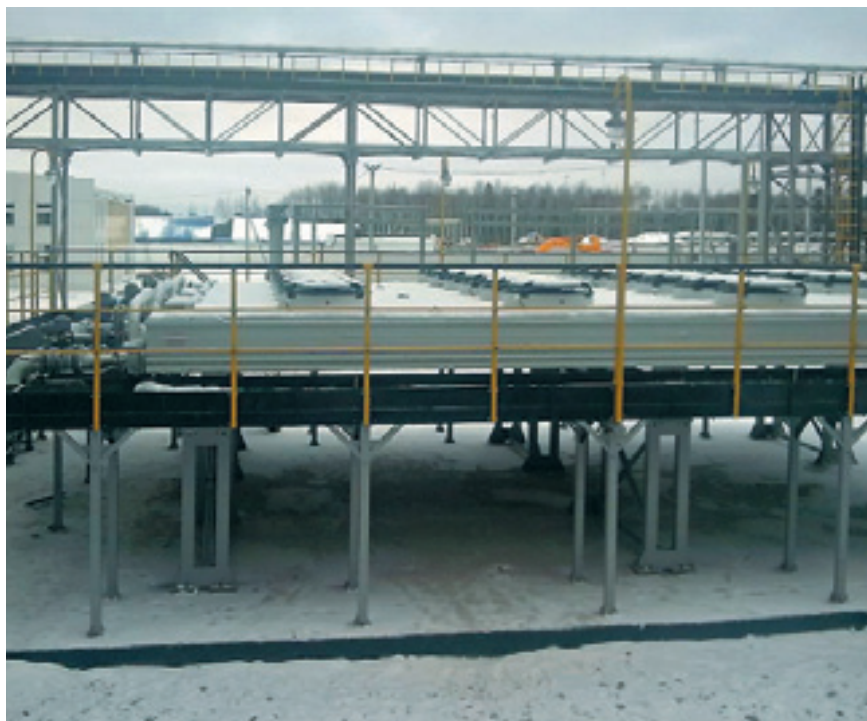
АВО системы охлаждения энергоблока
