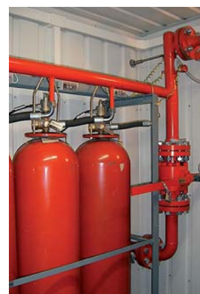
Автоматизированная система пожаротушения газотурбинной электростанции Урал-6000
