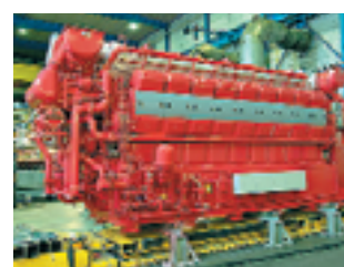
Фото на обложке. Парогазовая электростанция мощностью 517 МВт в г. Сумгаит (Азербайджан)
