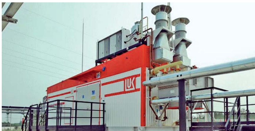
Винтовая компрессорная установка на Повховском месторождении (ПАО «Лукойл»)
