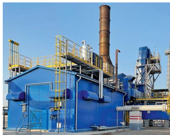
Мобильные компрессорные установки для перекачки газа из трубы в трубу
