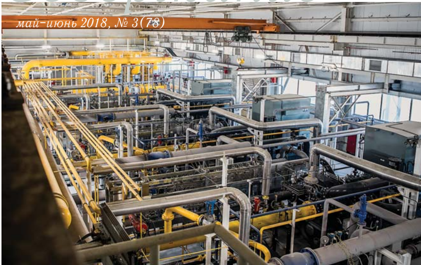
Фото на обложке: ДКС топливного газа на Казанской ТЭЦ-1
